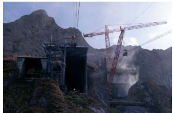
In der damaligen Bergstation von der 18 Tonnenseilbahn von Habegger entsteht heute die neue Bergstation für die erste Sektion Tierfehd - Chalchtrittli
