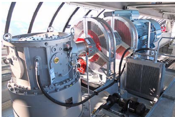
L'entraînement de la station d'altitude dispose d'une puissance de 600 kW.
