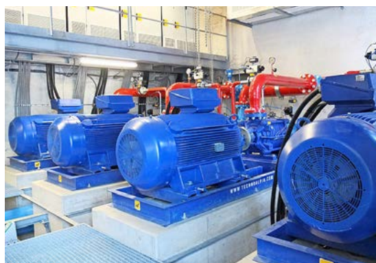
L'une des deux nouvelles stations de pompage a été édiée sur le château d'eau de Thyon.
