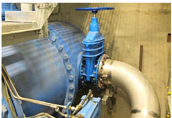
500 l d'eau par seconde peuvent être prélevés pour l'enneigement à partir du château d'eau Thyon.
