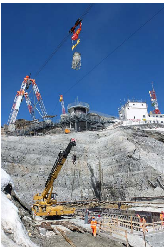
Die Talstation Testa Grigia auf 3458 m ü. M. und die darüber fahrende Materialseilbahn von Moosmair welche beide Stationen mit Material versorgt.
