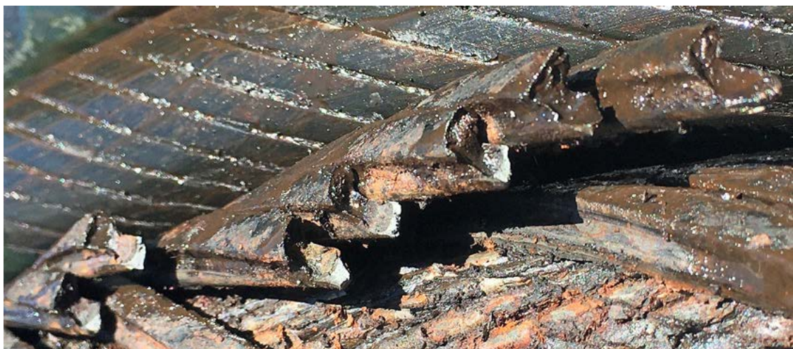
Bild 4: Spontan gebrochene Z-Drähte (frische Restbruchflächen deutlich sichtbar).
