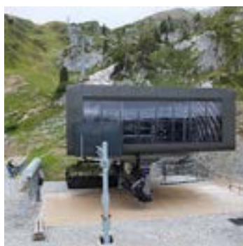
In der Talstation sind keine Geländer montiert, welche ein Verhängen von Materialien verursachen könnte.
