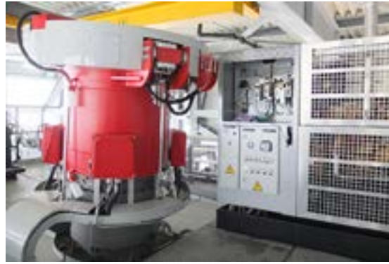
Der Antrieb besteht aus dem System Sector-Drive von Garaventa/Doppelmayr.
