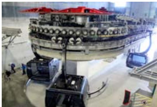
Les 44 cabines de la CWA offrent une capacité de transport de 2'200 personnes par heure, à une vitesse de 8 m/s.
