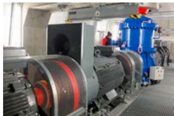
Les quatre moteurs ABB développent une puissance dynamique maximale de 2'300 kW.
