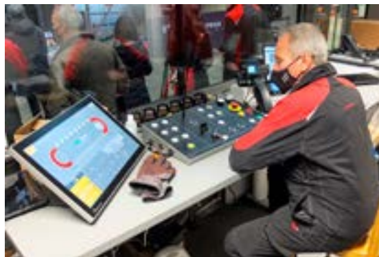
Die intelligente Seilbahnsteuerung der Doppelmayr Connect wurde von der Frey AG Stans eingebaut.
