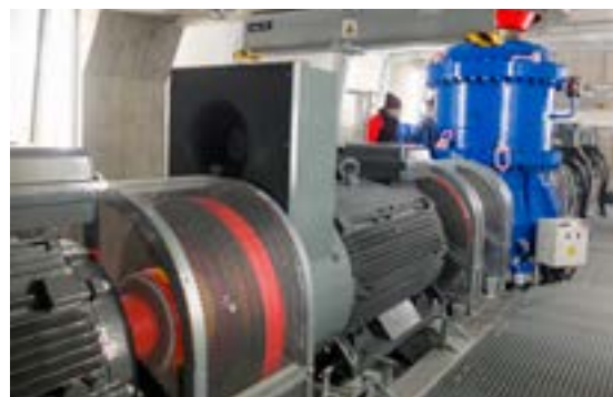
Die vier ABB Motoren erzeugen in der Bergstation eine maximale dynamische Leistung von 2300 kW.
