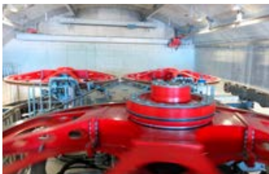
Das Antriebsrad in der imposanten und grossräumigen Bergstation Eigergletscher.
