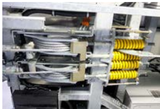
Die Komponenten der Zugseile- und Gegenseilbefestigungen unter dem Fahrzeug.
