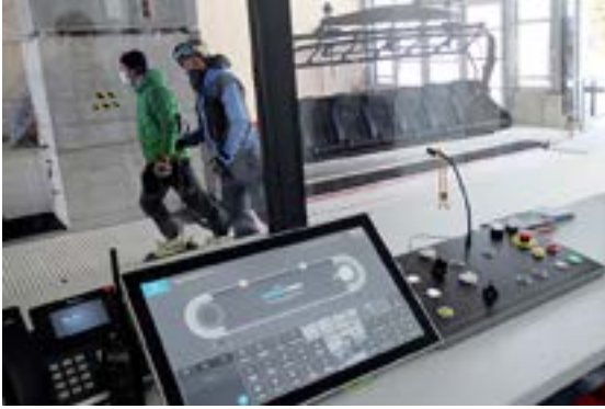
Die Steuerung stammt aus dem Haus der Frey AG Stans. Eine weitere wurde auf der Zubringer-Anlage eingebaut.
