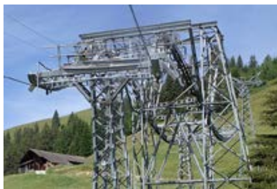
1981 baute Habegger am Rellerligrat in Schönried eine weitere 6er-Gondelbahn mit Kurve, die mit den Habeggischen schrägen Rollenbatterien versehen wurde.
