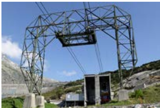
Damit das Gewicht der Schwerlastseilbahnen getragen werden konnte, baute Habegger stabile Portalstützen.
