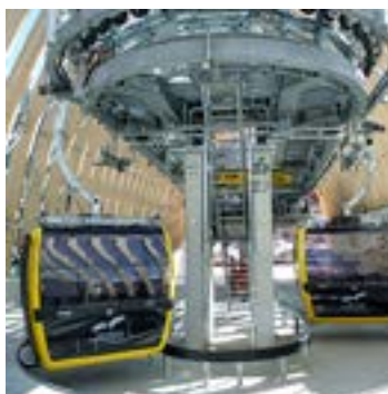
La moderne station inférieure du téléphérique a été étudiée et réalisée par le bureau d'architectes Hermann Kaufmann Partner ZT gmbh de Schwarzach bei Bregenz.
