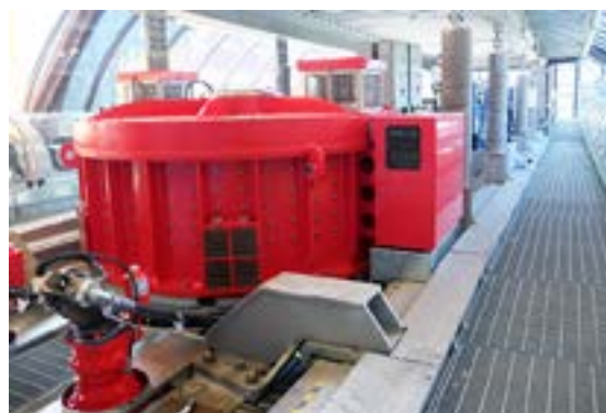
In beiden Sektionen ist der bewährte DirectDrive von Leitner eingebaut.
