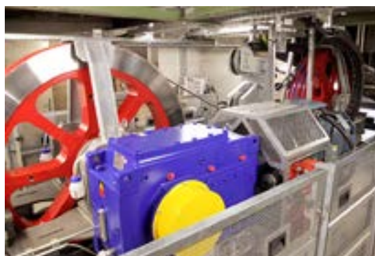
Die grundlegendste Erneuerung ist der Antrieb, der sich nun komplett auf einer Verschiebeeinrichtung befindet.
