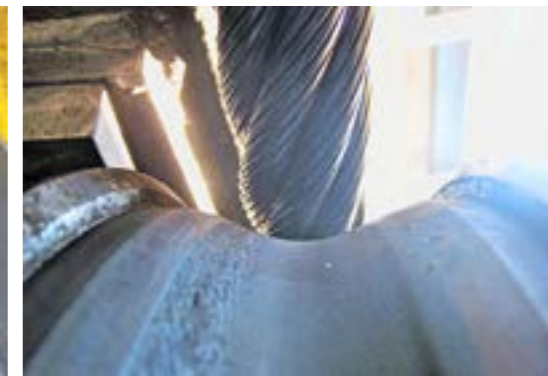
Bild 5: Einseitiger Verschleiss ist ein Hinweis auf Schräglauf eines Förderseils auf einer Rolle.
