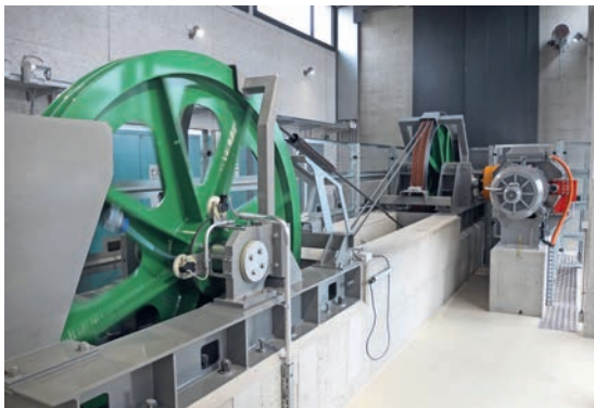
Der ABB Motor in der Bergstation erzielt eine Nennleistung von 218 kW.
