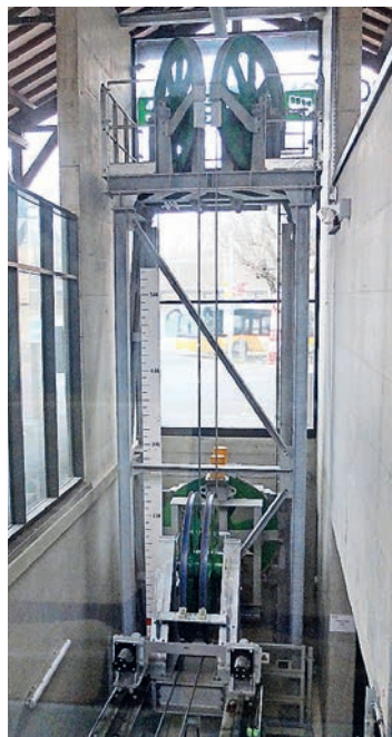
Wegen der schwachen Neigung benötigt die Anlage zwei Zugseile 25 mm und 19 mm. In der Talstation ist ein Gegengewicht für das untere Zugseil integriert.
