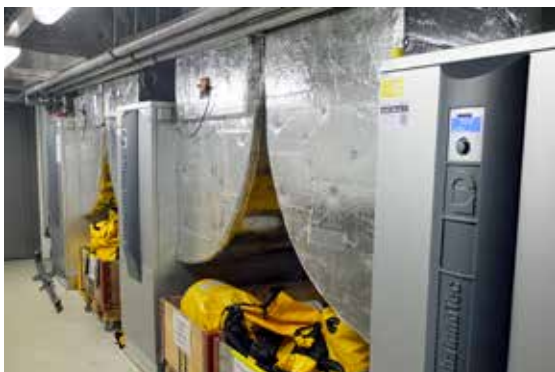
Drei Wärmepumpen erzeugen 45°C Heizwasser, welches an das Nachbarhotel abgegeben wird.
