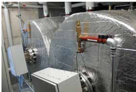
Um die Temperatur des Wassers aufrechtzuerhalten, war der Bau von zwei elektrischen Boilern notwendig.
