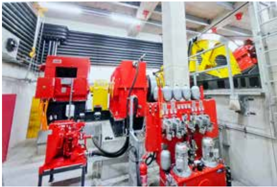
Die Abwärme der zwei Niederspannungsmotoren mit je 1,15 Megawatt für den Antrieb der Standseilbahn werden für die Warmwasseraufbereitung genutzt.
