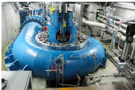
In der Pumpstation Zmutt sind fünf Maschinengruppen installiert. Eine davon wurde vor zwei Jahren durch ABB erneuert.
