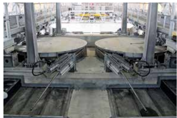
Die Abspannung der Tragseile in der Talstation auf der Testa Grigia, welche hydraulisch nachgezogen werden.
