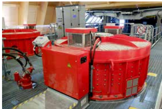
Die neue Anlage ist mit einem redundanten Leitner Direct Drive wie die Matterhorn Glacier Ride I ausgestattet.
