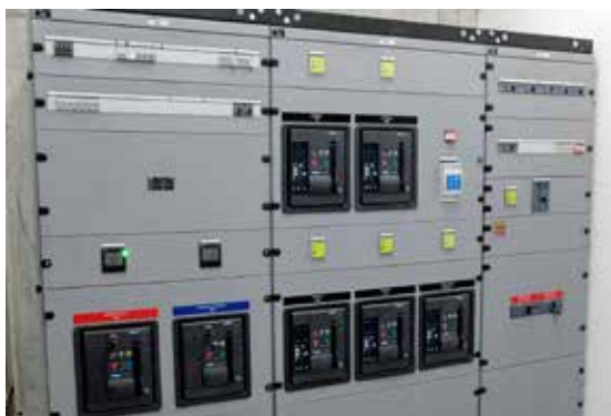
Die Stromversorgung der neuen 3S-Seilbahn auf dem Klein Matterhorn war eine besondere Herausforderung.
