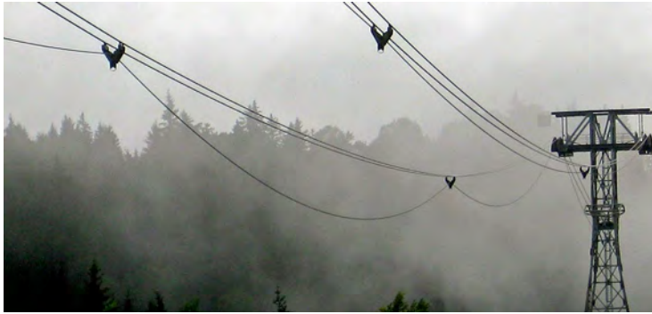
Abbildung 1: Wann der Durchhang eines unteren Zugseils zu gross wird, kann die Umfangskraft am Antrieb steigen!
