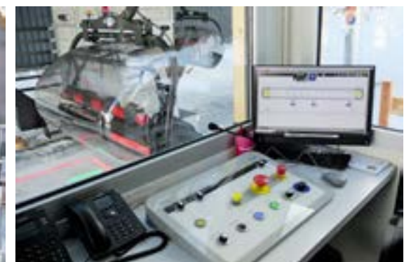
Die elektrische Steuerung wurde von Leitner geliefert und eingebaut.
