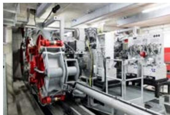
Der Antrieb des Funifors Murren-Birg ist in der Bergstation für eine maximale Leistung von 1770 KW pro Spur ausgestattet.
