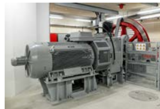
Die Pendelbahn ist in der Bergstation mit einem ABB-Motor mit einer Leistung von 1280 kW ausgestattet.
