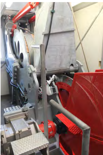
Im Antriebsgebäude ist ein 150kW Motor, Frequenzumrichter sowie wartungsfreie Bremswiderstände installiert.
