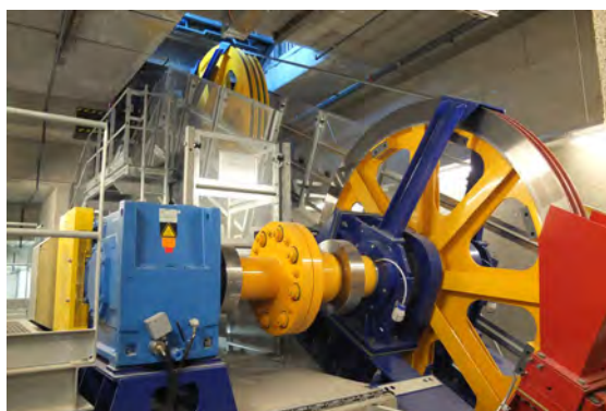
Der Antrieb der neuen Standseilbahn befindet sich in der Bergstation direkt im Zentrum des Bürgenstock-Resorts.
