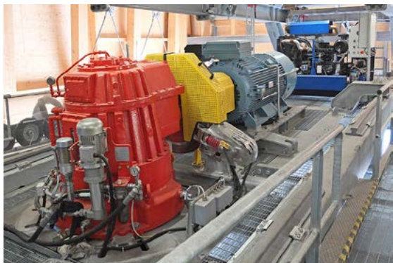
Bei den beiden Anlagen die auf dem Schneehüenerstock zusammen kommen, ist je ein von Leitner ropeways Oberflurantrieb eingebaut.
