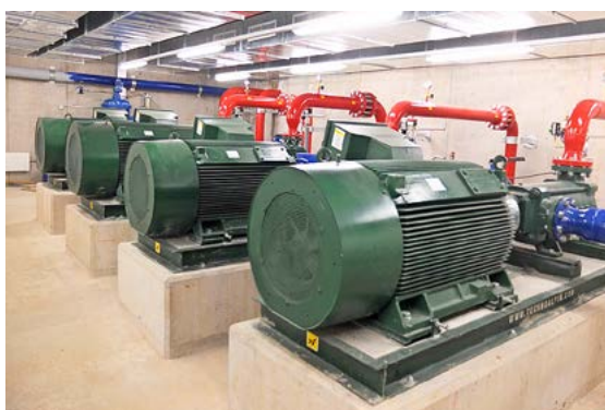
Vier Pumpen und vier Kompressoren sind in der Pumpstation auf dem Oberalppass untergebracht.
