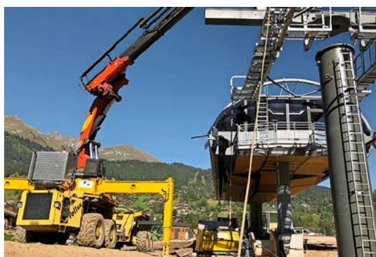
La station inférieure, et intermédiaire ont été construites en utilisant l'engin spécial «Castor et Pollux».
