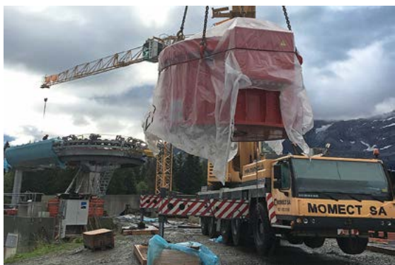
Une grue pour charges lourdes a été nécessaire pour le transport sur la station du DirectDrive.
