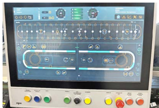
Die Steuerung wurde von der Firma Sisag aus Schattdorf installiert.
