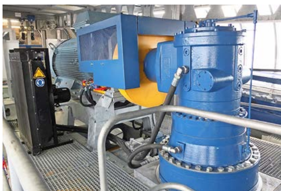
Der Antrieb der Anlage wird mit einem ABB-Motor sowie mit einem Brevini-Getriebe bewerkstelligt.
