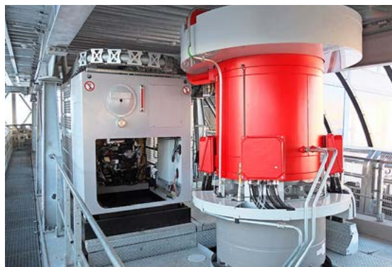
Als Antriebssystem kommt ein Doppelmayr-Sector-Drive (DSD) zum Einsatz.
