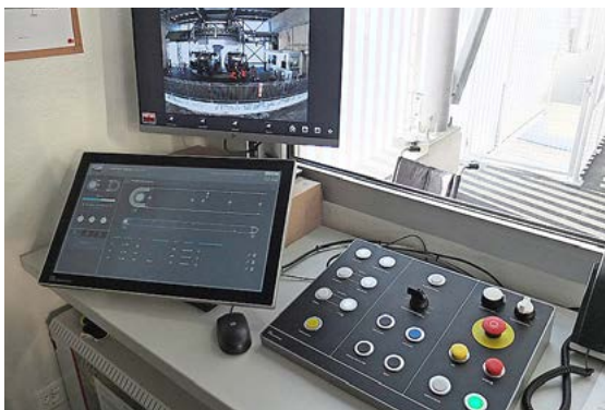
Die Doppelmayr Connet Steuerung der Firma Frey AG Stans begeistert die Mitarbeiter.
